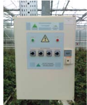
Щит управления мотор-редукторами
